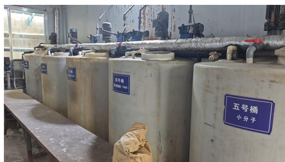
图 8-3 废水治理设施
