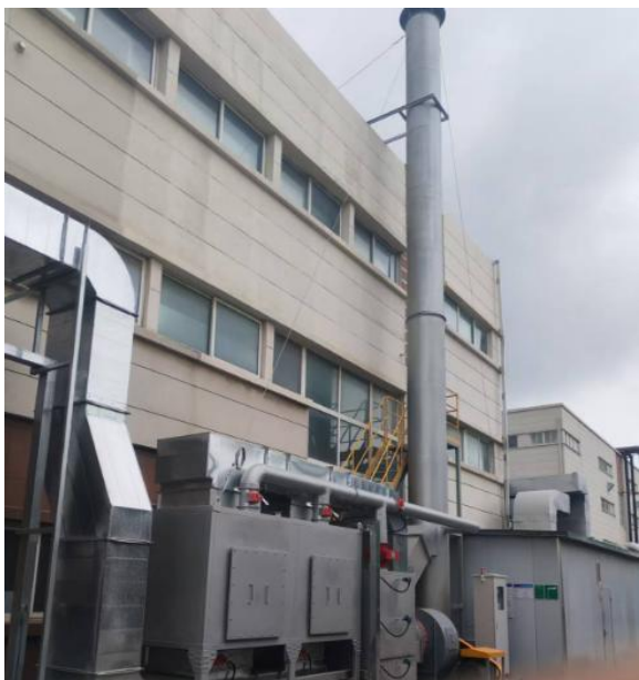
4#车间排气筒（DA012）
